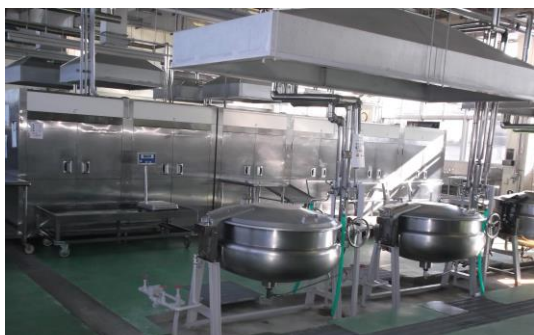
調理室 (回転釜付近)
