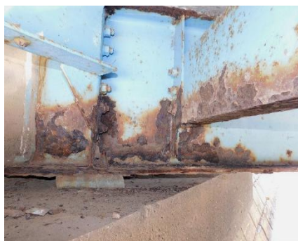
No.86 浜川4号橋 主桁：腐食、防食機能の劣化
