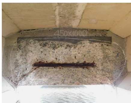
No.94 真亀橋 主桁：剝離・鉄筋露出
