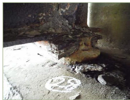
No.3 後田橋【健全性Ⅲ】 （支承Ⅲ）腐食、（主桁Ⅱ）腐食 海岸線距離 2.70 km
