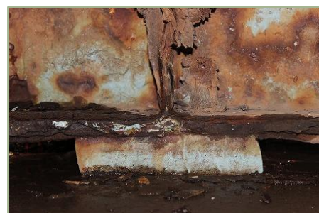
No.86 浜川4号橋【健全性Ⅲ】 （主桁Ⅱ）腐食、（支承Ⅲ）変色・劣化 海岸線距離 1.20 km
