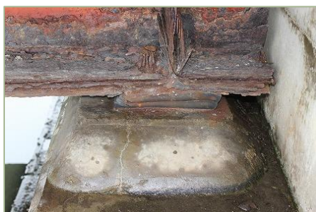
No.51 浜川1号橋【健全性Ⅲ】 （主桁Ⅲ）腐食、（支承Ⅲ）変色・劣化 海岸線距離 1.10 km
