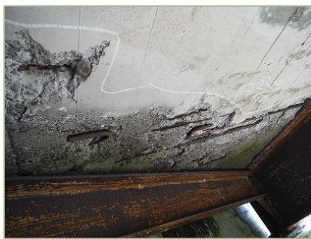
No.2 右衛門川橋【健全性Ⅲ】 （床版Ⅲ）剥離・鉄筋露出 海岸線距離 2.70 km
