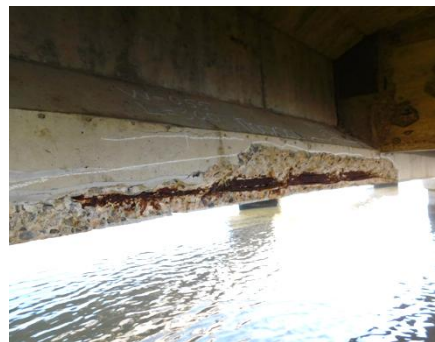
No.94 真亀橋 主桁：剝離・鉄筋露出
