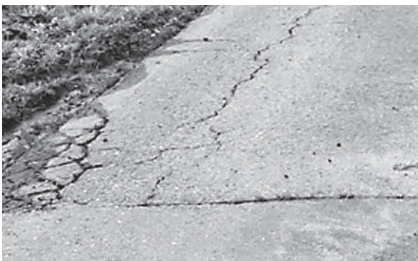
生活道路上の亀裂
